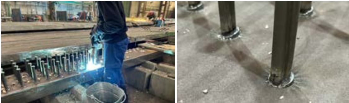
Abbildung 1: Bolzenschweißen mittels Prozess Nr. 783 nach DIN EN ISO 4063 [2] (links); Kopfbolzen mit stark ungleichen Schweißwulsten sowie einseitigem Unterschnitt aufgrund der Blaswirkung (rechts); Bildquelle: Ingenieurgesellschaft für Stahlbau und Schweißtechnik mbH (beide)
