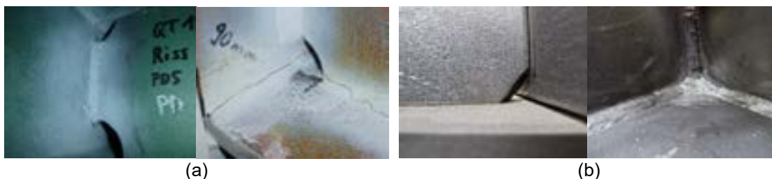
Abbildung 1: (a) Schadensbilder an Querträgerfreischnitten [SBN]; (b) Neuartiges Kerbdetail (angeschrägte, angefastete und verschweißte Querträgerrecke) [SBN]
